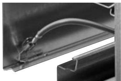
Заземление верхней крышки канала BRS
